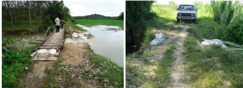
Jalan Hubungan Tidak Sempurna
